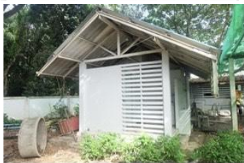
ห้องน้ำห้องส้วม อายุการใช้งาน ๑๕ ปี
