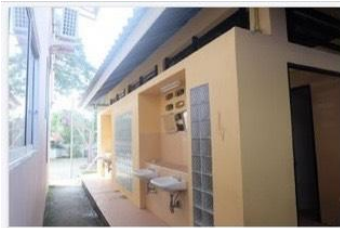
ห้องน้ำห้องส้วมนักเรียนหญิง ๖ ที่/๔๙ อายุการใช้งาน ๑๐ ปี
